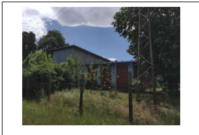
Трафо станица 20/0,4 kV
